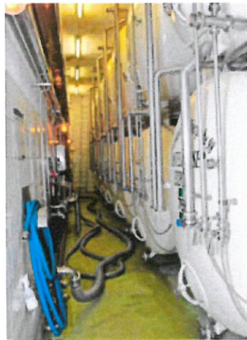
17 Gärtanks gibt es im Keller der Distelhauser Brauerei.
